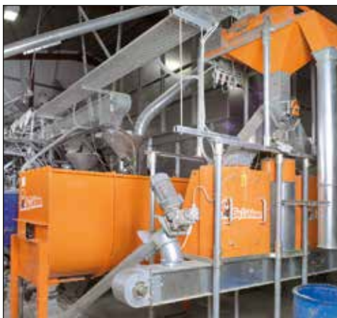
Futterküche mit Futtermühle, Mischer und HydroMix
