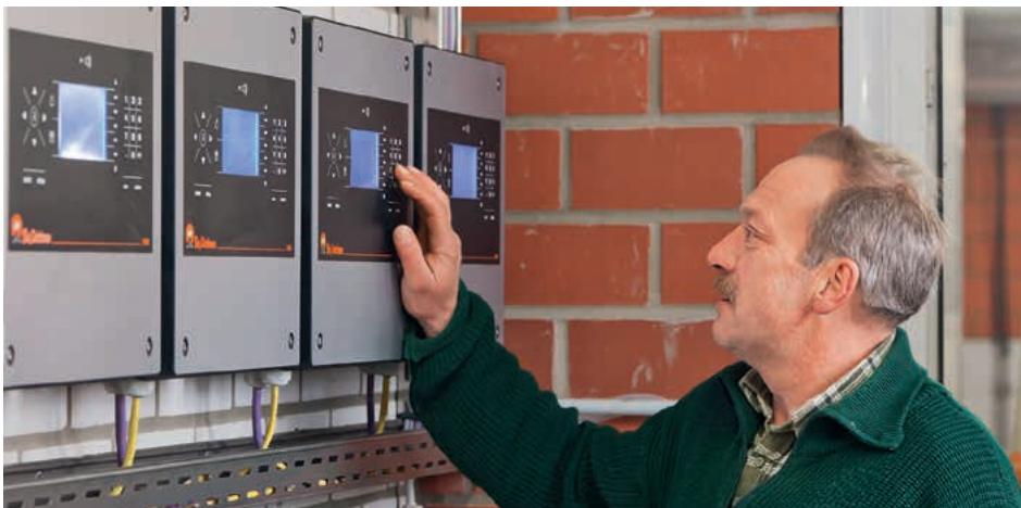
Jede Sortierwaage TriSortpro wird von einem Controller gesteuert, die hier im Vorraum installiert sind
